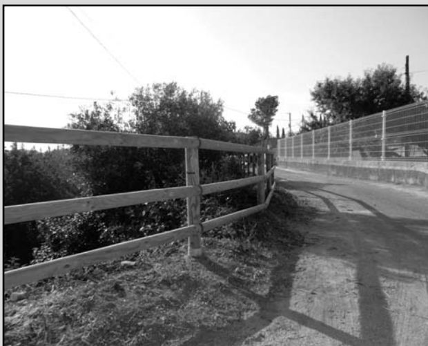
Col·locació d'una barana protectora al Camí Darrera del Camp de Futbol a l'accés a la Via Verda
